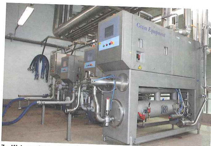
Zur Wahrung des kontinuierlichen Produktionsablaufs stehen insgesamt vier Freezer zur Verfügung; einer als Reserve
